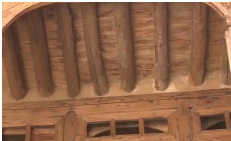
عکس از سقف اتاق بدون مسطح
